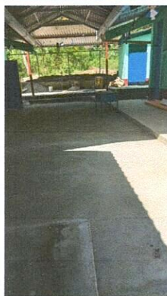
Foto 4: Necesidad de reparación de losa de patio
